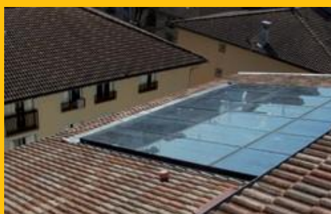
Installation photovoltaïque dans le centre de Grenoble
