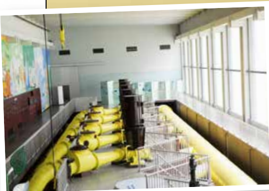
© Régie des eaux de Grenoble
